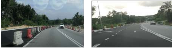
Gambar 2.33: Kerja-Kerja Naiktaraf Sistem Lalulintas Di Jalan Permas Utara, Bandar Baru Permas Jaya, Johor Bahru.
