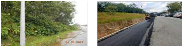
Gambar 2.4: Kerja-Kerja Menaiktaraf Sistem Perparitan dan Pembaikan / Penurapan Jalan di Jalan Berjaya 8, Kawasan Perindustrian Berjaya, Johor Bahru.
