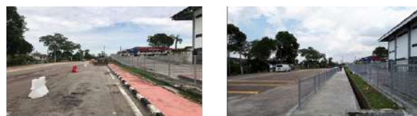
Gambar 3.13 : Kerja-Kerja Menaiktaraf Pejalan Kaki Dan Pembinaan Penghadang Jalan Bagi Pengasingan Laluan Pejalan Kaki Dan Laluan Bermotor Serta Kerja-Kerja Berkaitan Di Taman Johor Jaya.
