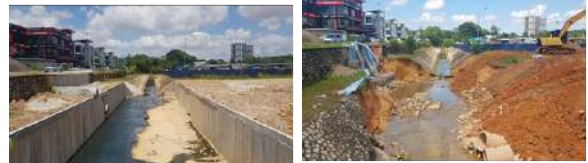
Gambar 2.22: Cadangan Kerja Pembaikan Parit Utama Di Jalan Mutiara Emas Puteh, Taman Mount Austin, Johor Bahru.
