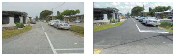
Gambar 3.2 : Kerja-Kerja Menurap Semula Jalan Dan Menyediakan Garisan Jalan Serta Kerja-Kerja Berkaitan Di Taman Sentosa Dan Taman Sri Tebrau, Johor Bahru.
